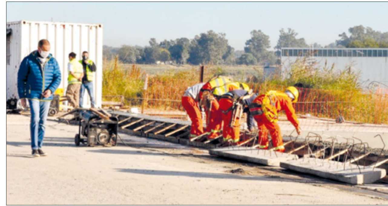
Gustavo Arrieta, titular de Vialidad Nacional, supervisando el avance de la obra.
