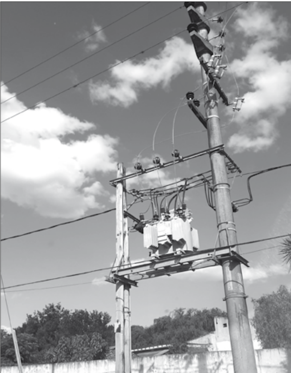
Los transformadores observados por los vecinos se ubican sobre calle San Martín, desde la Ruta 3 hacia el final del barrio Peluffo sobre Berutti.
